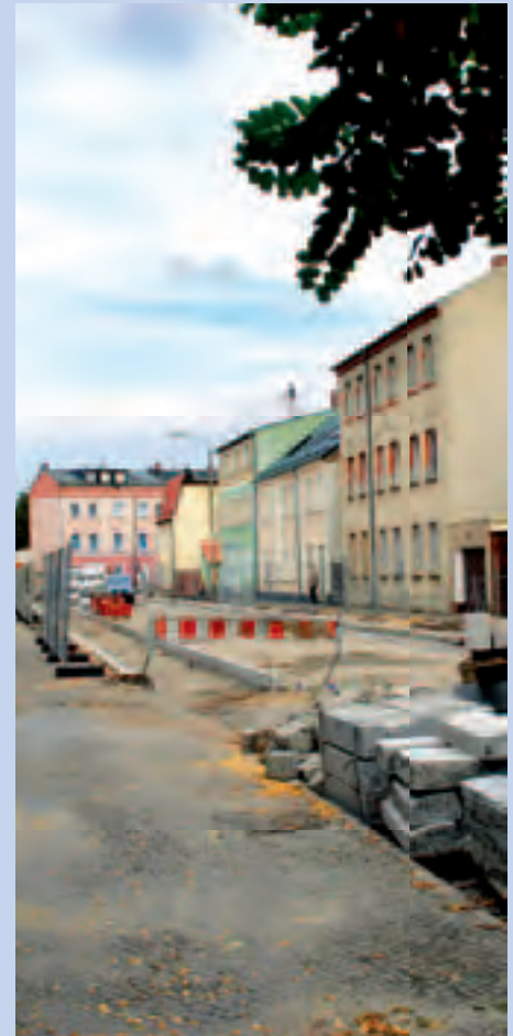
Die NUWAB erneuert im Zuge von Straßenbaumaßnahmen defekte Trink- und Abwasserleitungen in der Frankenstraße.
